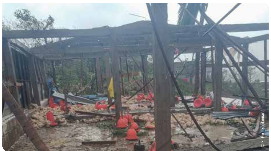
Près de 80 % des producteurs de volailles et poules pondeuses ont été touchés, comme ici sur l'exploitation d'El-Enrif Soulaïmana, à Ouangani. Une problématique majeure pour les plus de 321 000 habitants, population qui a doublé en 25 ans et qui vit pour 77 % sous le seuil de pauvreté.
